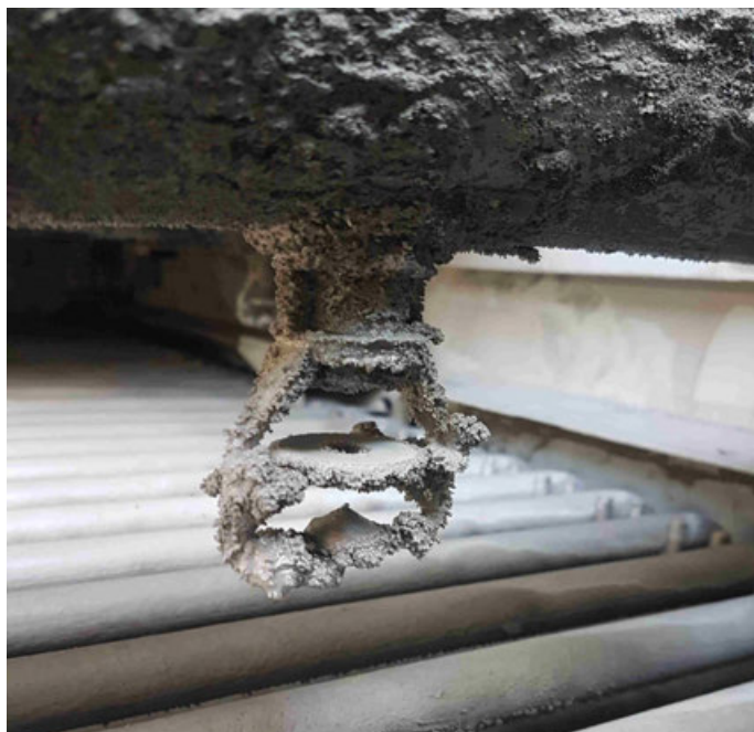
Abb. 2 Verblockte Sprühdüse (Foto: Dipolique)
